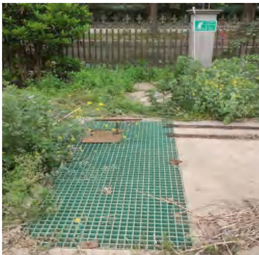
图4.1-2 雨水排放口图片
