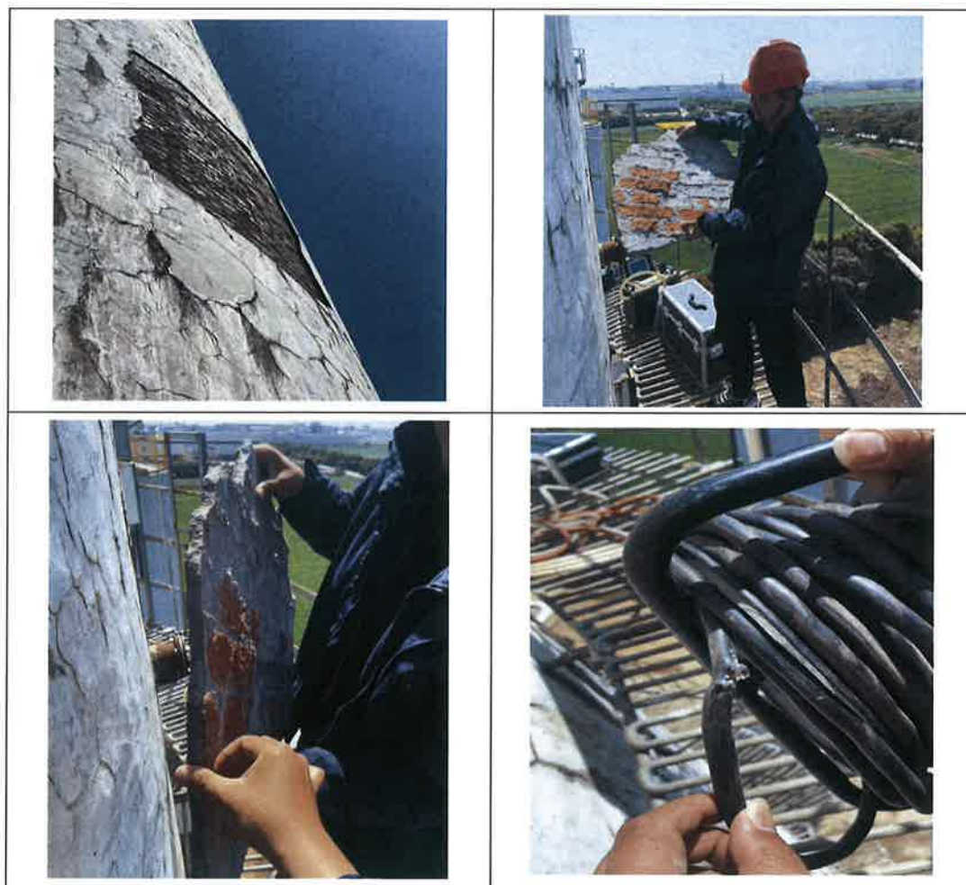
图1 焚烧炉墙体脱落现场图片
