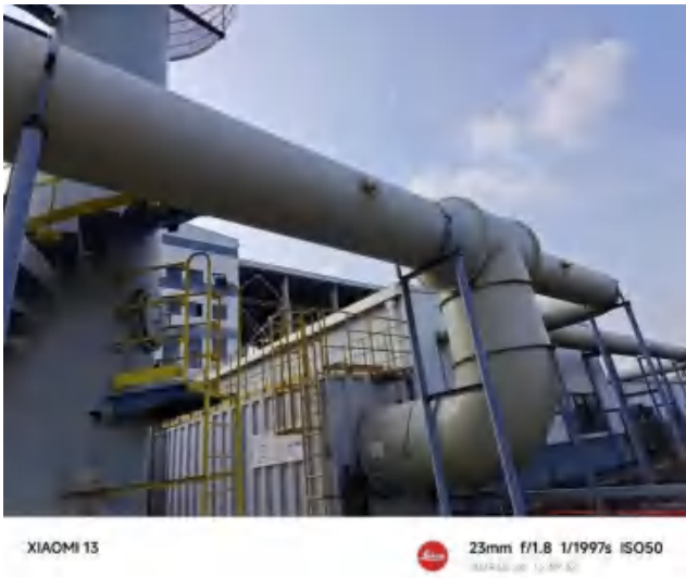
废物贮存车间废气收集管道
