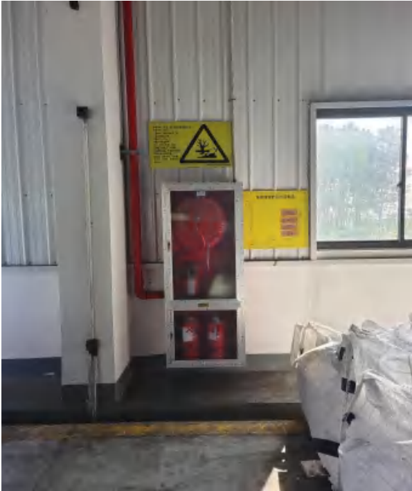
贮存间（危废仓库）内部情况
