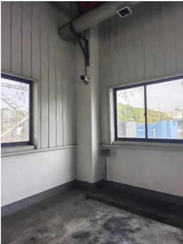
内部监控、收集沟、检视窗
