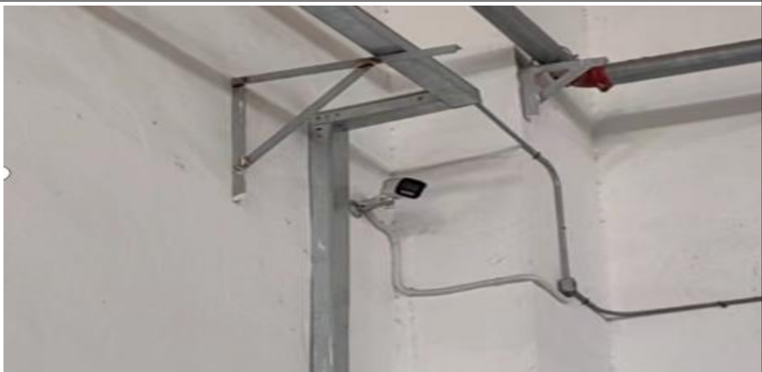
仓库内、外部分监控
