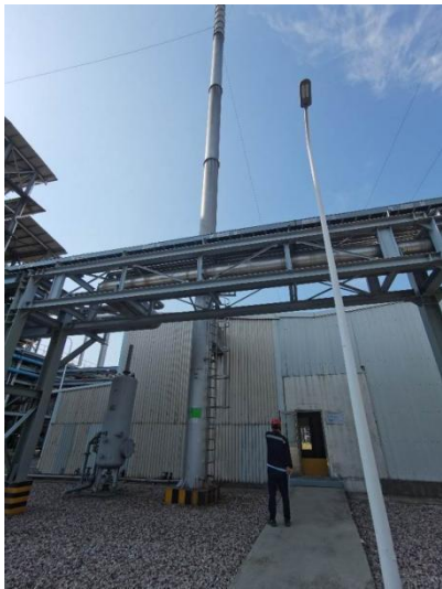
DA011排气筒及取样平台
