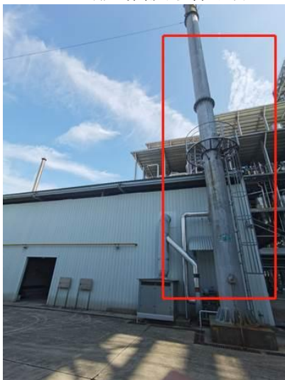
DA014排气筒及取样平台
