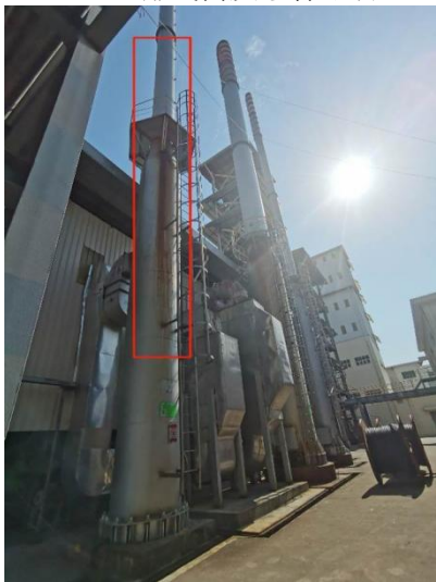
DA010排气筒及取样平台
