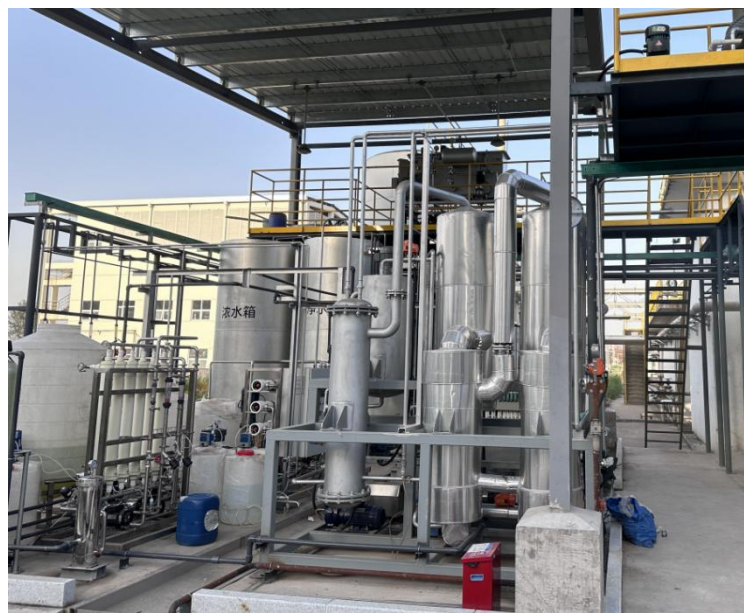
图4.1-2 新建废水处理回用系统照片
