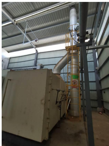
催化燃烧装置及DA008排气筒、取样平台
