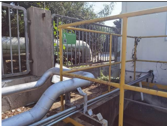
废水监测井及排口
