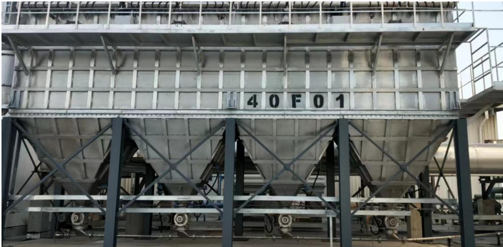
造粒车间的布袋除尘器
