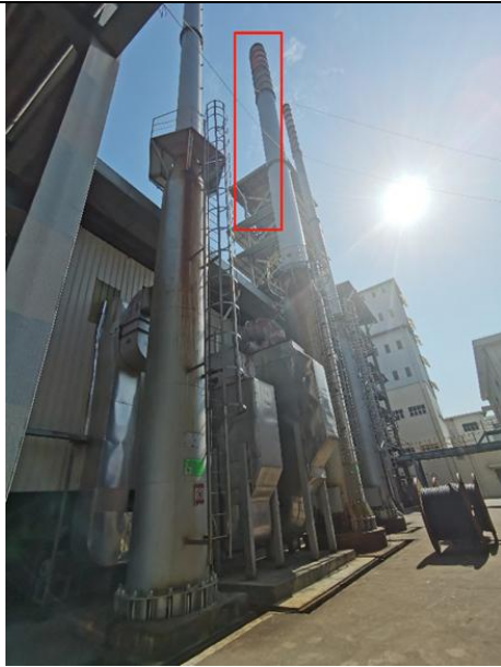
DA009排气筒及取样平台
