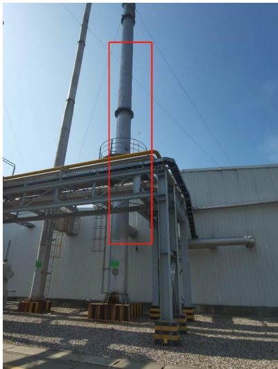
DA013排气筒及取样平台
