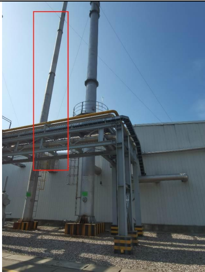
DA012排气筒及取样平台
