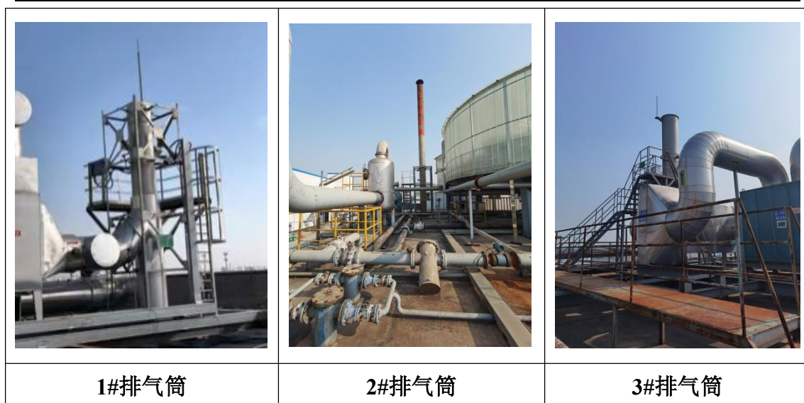
图 4.1-4 有组织废气排放口
