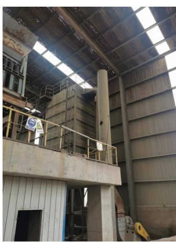
破碎、粉碎工序布袋除尘器
