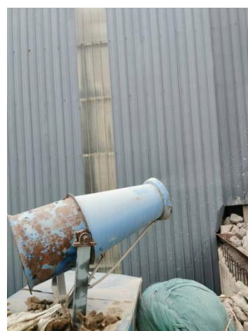
投料粉尘、输送工序通过喷淋 降尘装置抑尘
