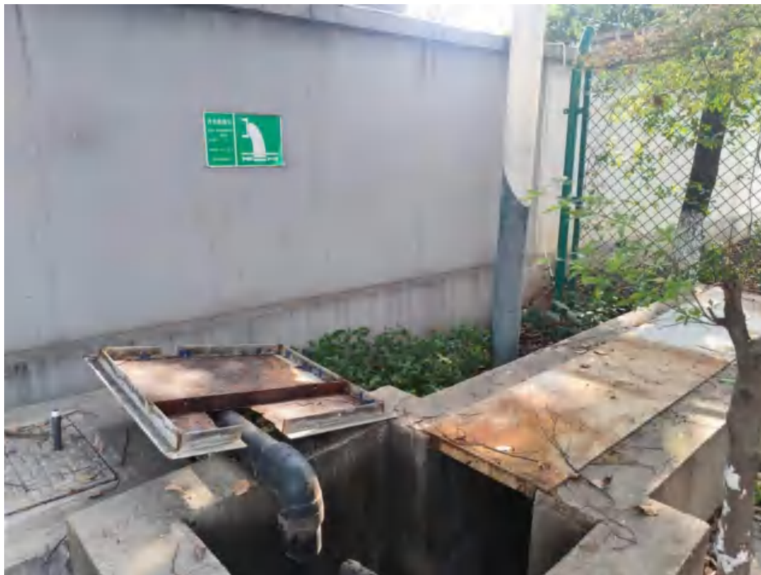
图 6.1 生活污水接管口
