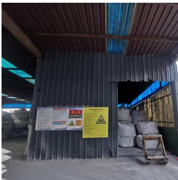
现有危险废物贮存设施
