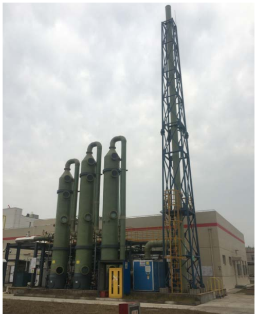
21#排气筒（三级洗涤塔）
