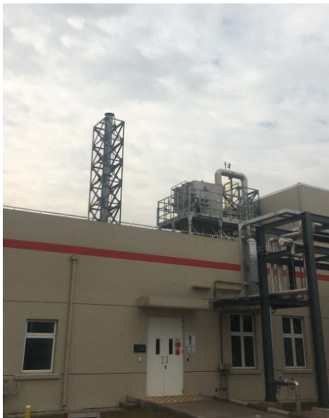
20#排气筒（中央除尘器）
