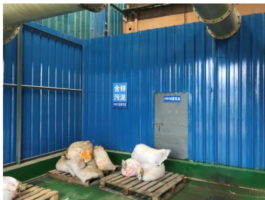
地面有破损以及裂缝
