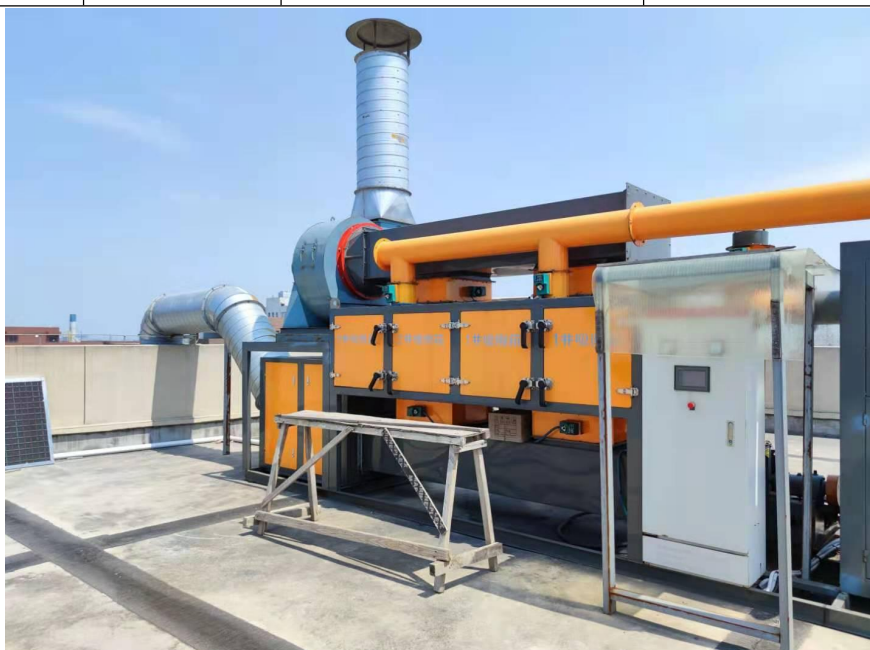
图 5-1 活性炭吸附+催化燃烧（RCO）装置
