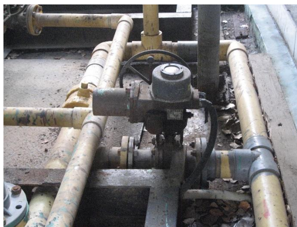
废水处理站切断装置
