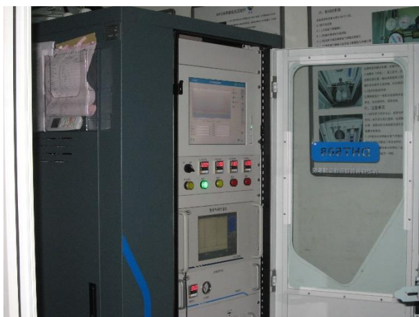
RCO 废气处理设施 VOCs 在线装置
