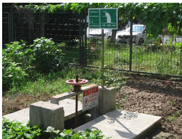
雨水排放口切断装置
