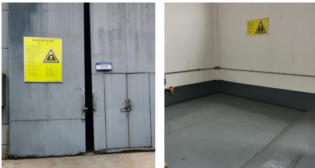
图4.1-3 危废仓库现场照片
