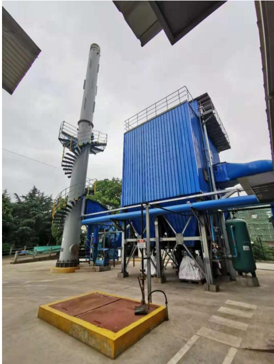
图 5-1 本项目废气处理装置
